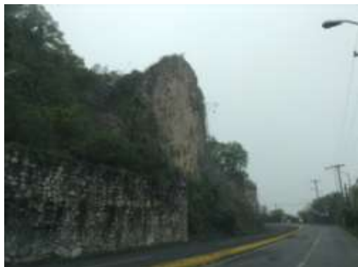
Figura 11. Carretera de acceso al Parque Nacional Cumbres en día lluvioso. Percepción del peligro natural de deslaves.
